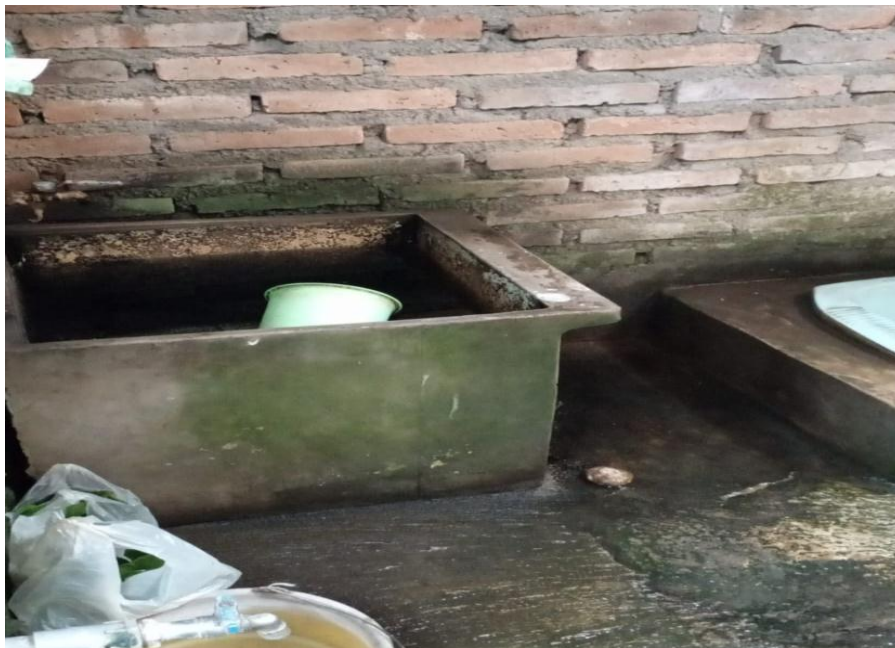
Gambar 2. Kondisi Tempat Penampungan Air
