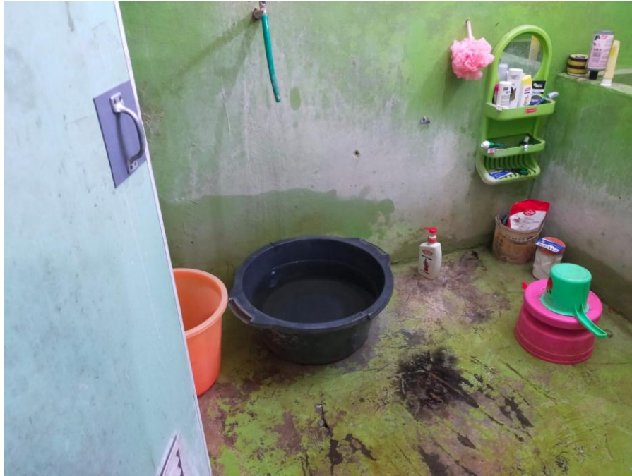
Gambar 1. Kondisi Tempat Penampungan Air
